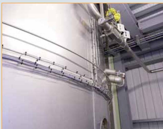
> Sur cuves et silos
